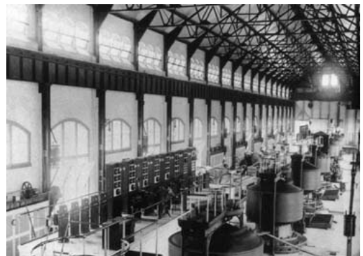
Interno della centrale elettrica delle cascate del Niagara, in basso a destra sono visibili i generatori di corrente alternata ( alternatori ) progettati da Tesla.
