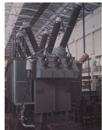
Trasformatore da 315 MVA, 420 kV/18 kV (Comelmar Italia)
